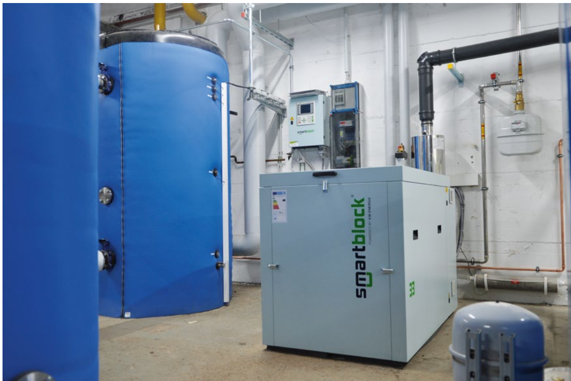
BHKW, Autohaus Bald AG, Siegen: Hier sind neben Heizung und Warmwasser auch Dampfstrahler, Reifen- und Teilewaschanlage sowie die Lackieranlage angeschlossen.
